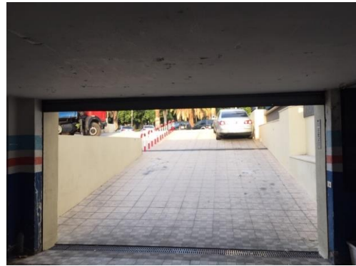
Salida trasera hacia la Avenida de Madrid. La puerta del garaje está estropeada, y permanece abierta de manera permanente. Requeriría actuaciones en el momento de ser reparada.
